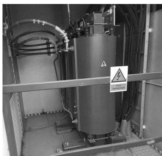
Rys. 2. Transformator wewnątrzowy o mocy pozornej 1250kVA (Transformator 2)
