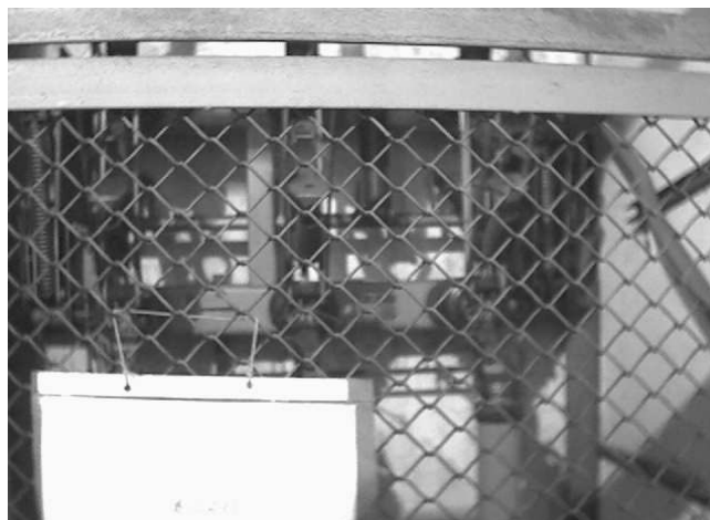
Rys. 3. Fotografia rozłącznika w polu transformatora
