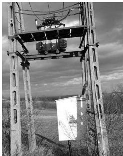
Rys. 1. Transformator napowietrzny o mocy pozornej 250kVA (Transformator 1)
